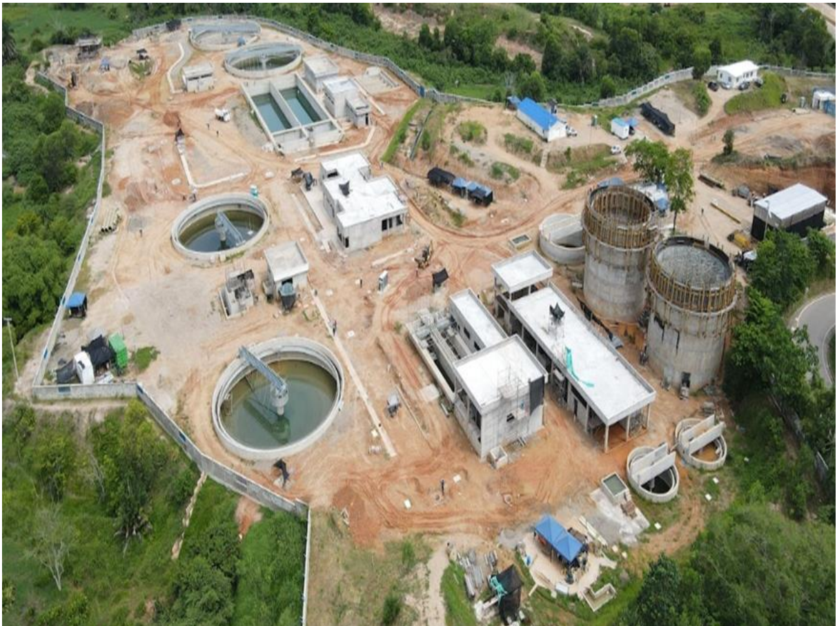
Fotografía Planta de Tratamiento PTAR San Silvestre
